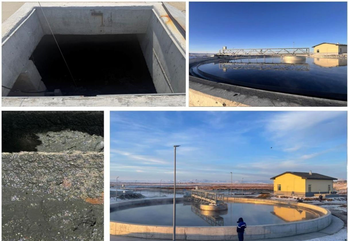
Abbildung 34. Zentrale Abwasserreinigungsanlage Darkhan
